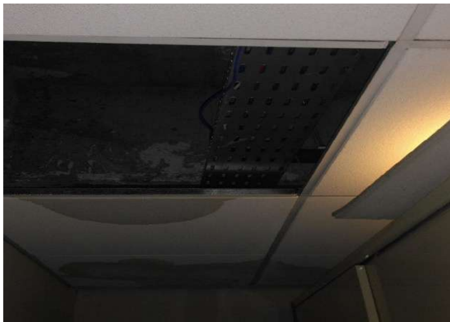
Figura 85: Local por onde entrou a água entre as estantes fechadas: ocorrência de 2017
