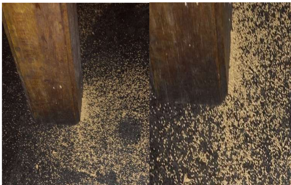
Figura 55: Excrementos de cupins (de madeira seca) caídos após mexer na madeira
