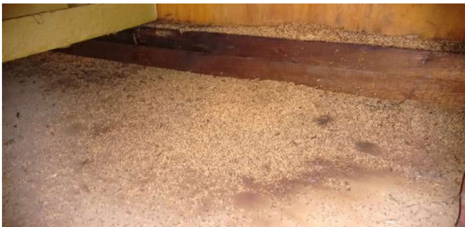
Figura 09: Mobiliário do SEP que foi atacado por cupim de madeira seca (2015)
